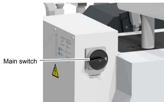
Img. 1-1: Main switch
